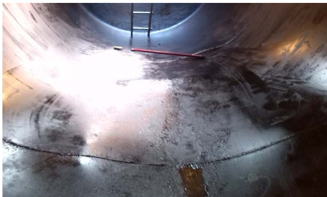
Deformacije u unutrašnjosti rezervoara R4 – b/s „Gradiška“
